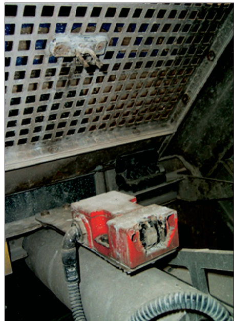
Abbildung 7: Verriegelungseinrichtung, die ungünstigen Umwelteinflüssen ausgesetzt ist
